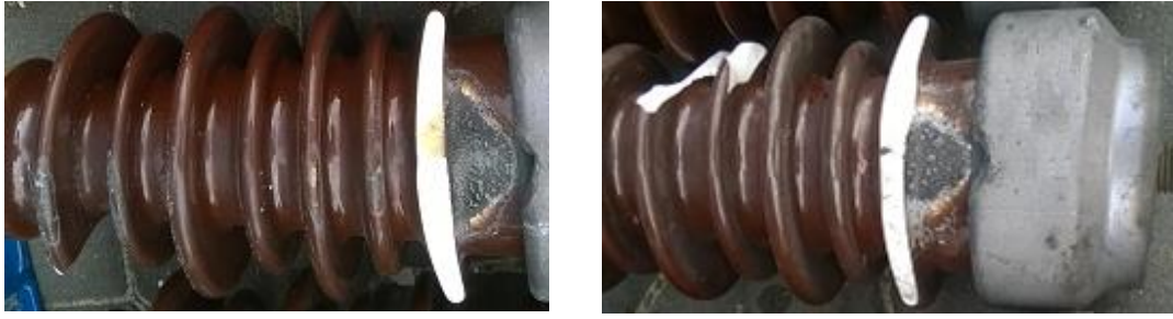
Fot. 2. Uszkodzone izolatory ŚN [6].
