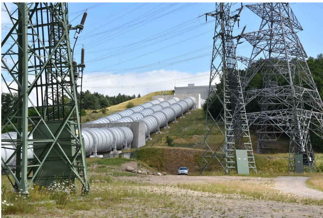
Fot. 2 Trzy rurowości górnej wody, „spływające” w dół ku elektrowni
