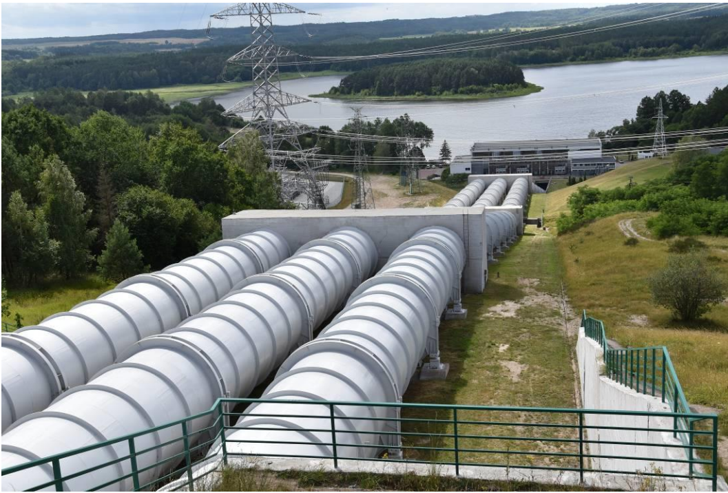
Fot. 3 Rurociągi górnej wody, w oddali wyspa na jez. Kwiecko
