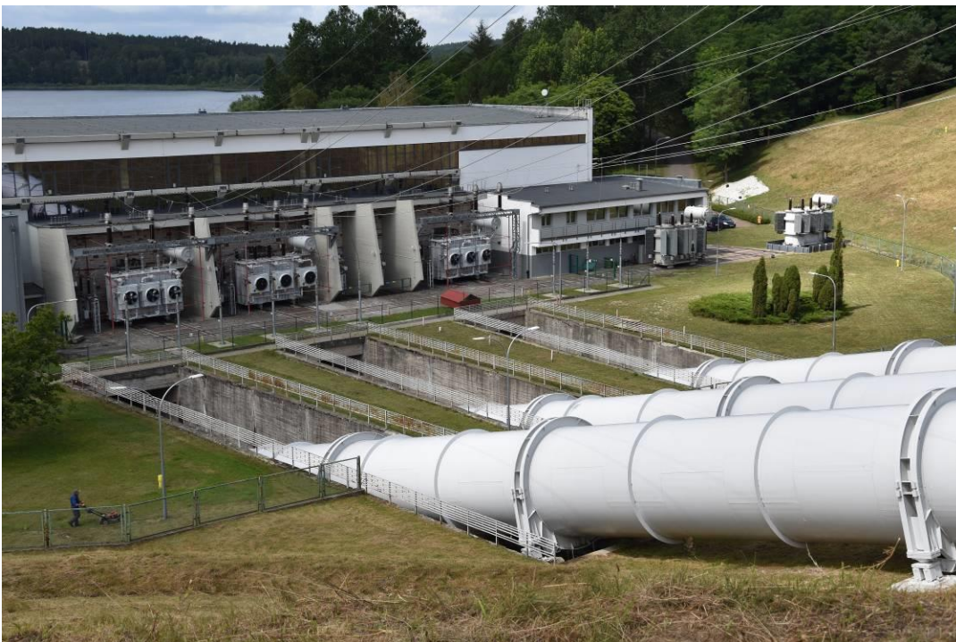
Fot. 4. Rurociągi górnej wody wchodzące do podziemnych turbin
